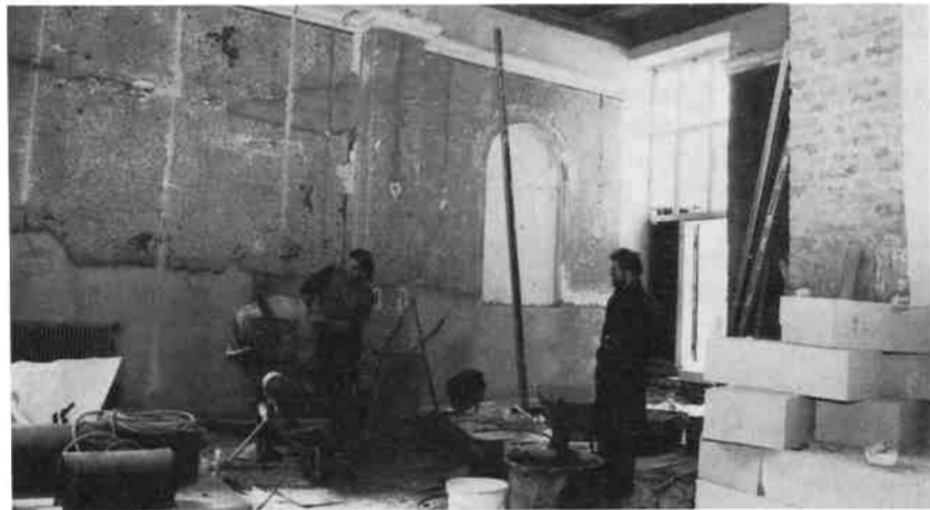
Wir bauen ein Theater... (Hier entstehen das neue Foyer und die Toiletten)
